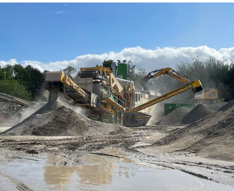
Beton-Recycling-Anlage in Berlin Marzahn
